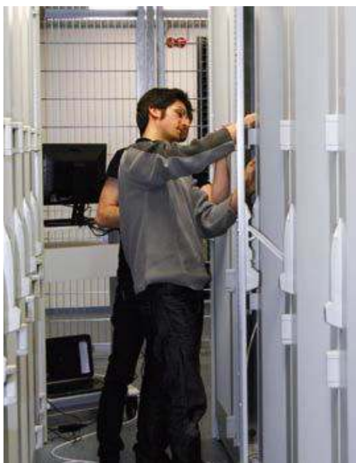
IT-Personal von Noris Network beim Einbau eines Servers.
